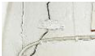
Lézardes sur enduit de plâtre revêtu
