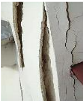
Soulèvements spectaculaires d'enduit de plâtre revêtu, sels de Candlot
