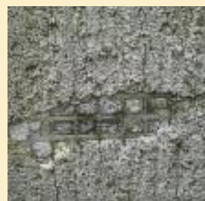
Une seule couche de sous-enduit ; l'armature n'a pas été recouverte
