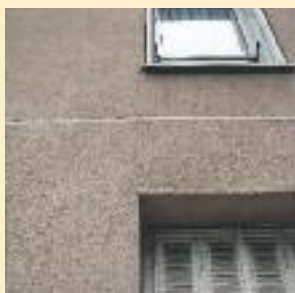
L'absence de mouchoirs d'armature dans les angles de baies
