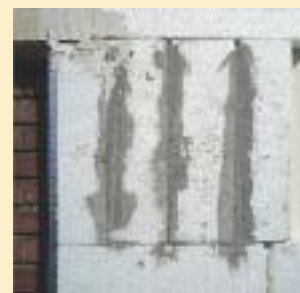
Une mauvaise pose de l'isolant
