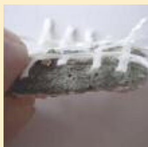
L'absence totale du sous-enduit armé
