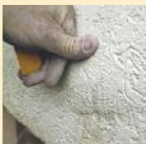
L'application d'un revêtement trop imperméable
