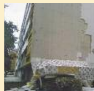
Une mauvaise fixation de l'isolant
